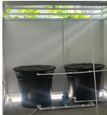
Cuarto de máquinas área de la piscina
